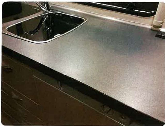
9.2 Kjøkkenbenk skadet Benkeplate skadet
