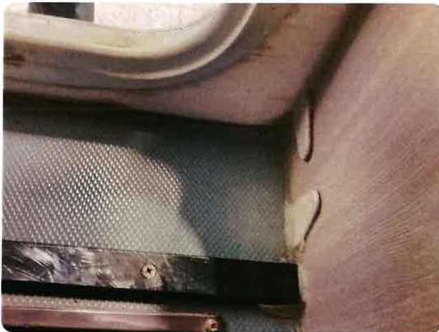
2 Målt fukt i % 60 Måler 60 % fukt i golvet i gasskasse. 30% målt i vegg under luke. Trolig lekk fra lasteluke. Tapet misfarget
