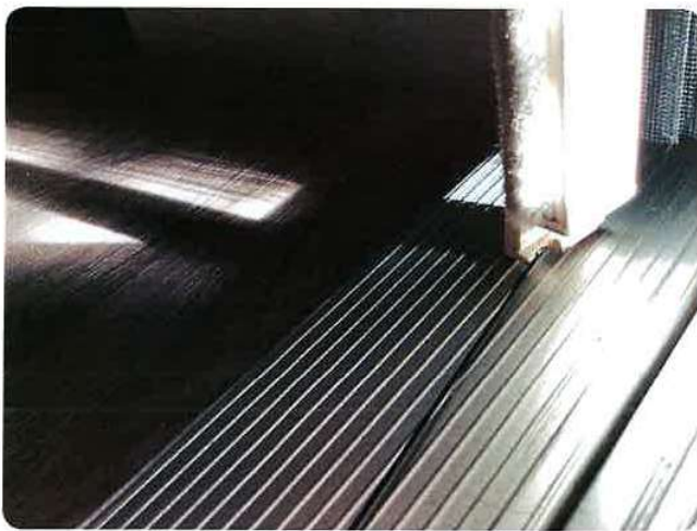
2.4 Øvrige feil Løs myggdør + ødelagt i bunn. Hopper ut av spor
