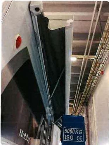
8.3 Defekt Markise går ikke som den skal. Henger igjen i bakkant. Skade på hovedarm venstre. Bakre
