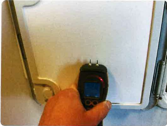
1 Målt fukt i % 52 Fukt i toalettluke.
