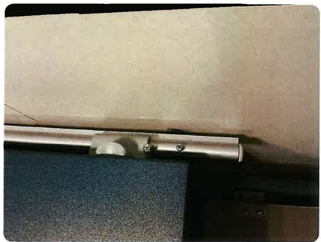
9.7 Skade på interiør Bortfeste løsnet fra veggen. Må montere ei skinne som festes i veggen med lim/ skruer
