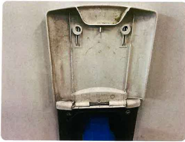
2.6 Øvrige feil Defekt feste fjær lokk over strømkontakt
