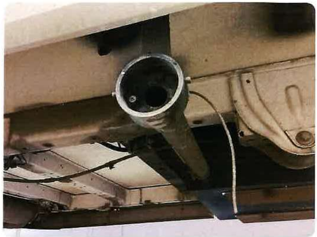
2.1 Øvrige feil Mangler lokk spillvann
