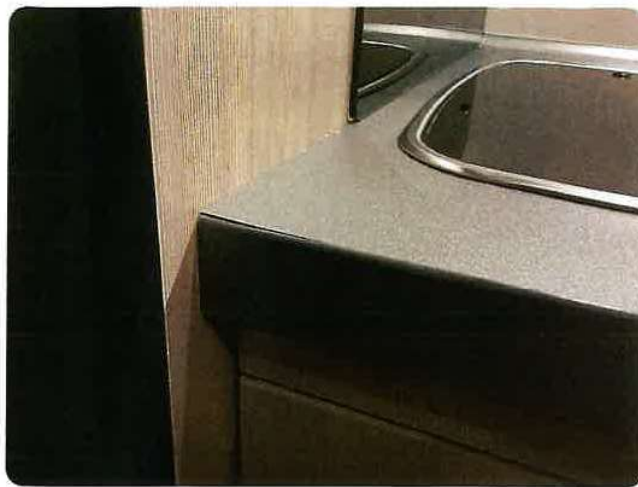
9.2 Kjøkkenbenk skadet Benkeplate skadet
