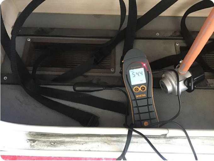
1 Målt fukt i % Vurderes evt tørkes. Gulv gasskasse
