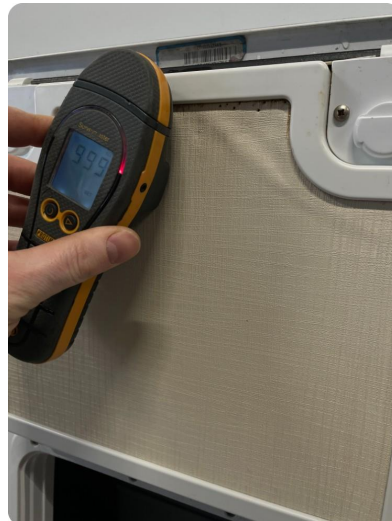
2 Målt fukt i % 99 WC luke, pakkes om. 100% utslag
