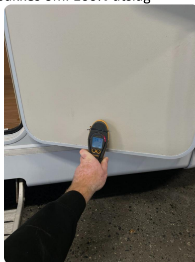
3 Målt fukt i % 99 Bunn til bodel dør brun, synlig skade
